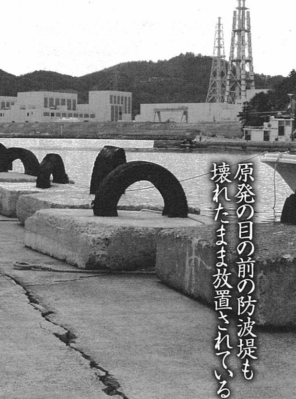
女川原発に隣接する漁港の防波堤は、巨大津波で地盤が沈下して一部が水没。コンクリート部分には大きな亀裂が入っていた。原発を津波から守るには防波堤が必要だが、整備は一向進まない
